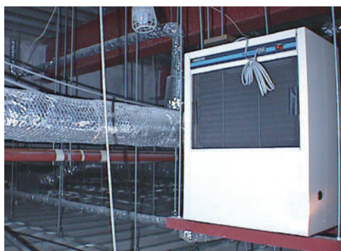
※食品工場天井裏の除湿
